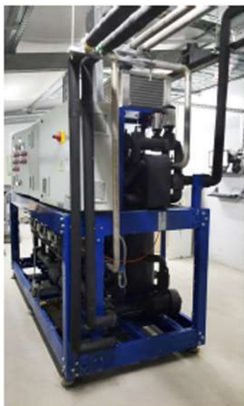
Sistema instalado en El Abastecedor en Buenos Aires.
