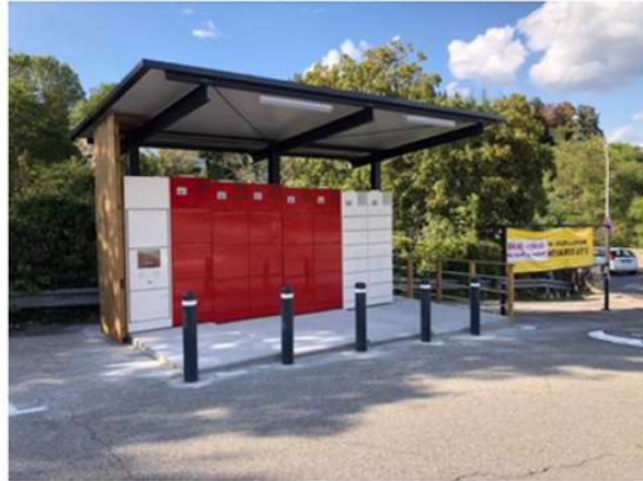
Casiers réfrigérés Epta installés en extérieur, ici des casiers de l'Intermarché de Privas en Ardèche.
